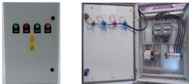
Рисунок 2.11 – пристрій (щит) АВР Hyundai ATS-125A 4P
